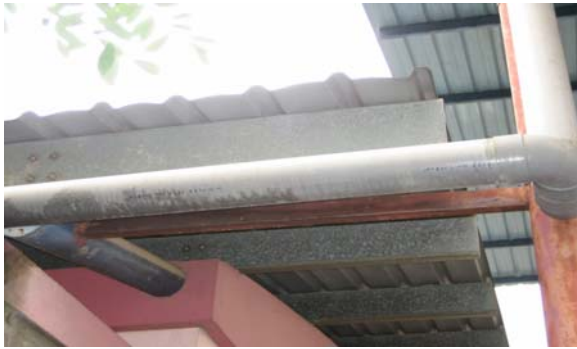
a. Rainwater pipe
